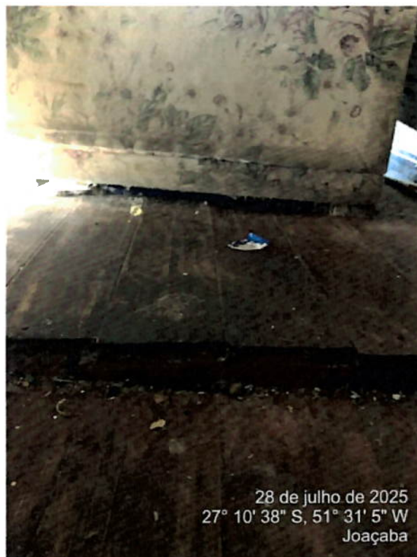
Foto 15 – Vista do descolamento do assoalho
