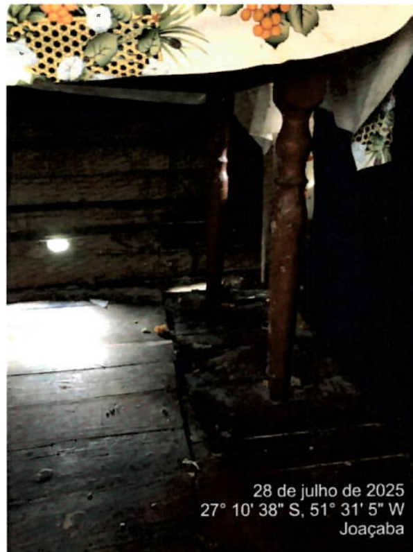
Foto 9 – Vista do assoalho apodrecido
