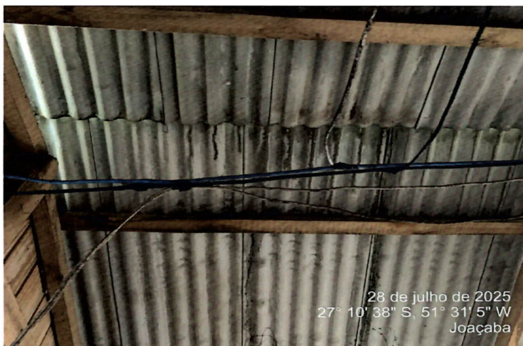
Foto 5 – Vista da fiação exposta
