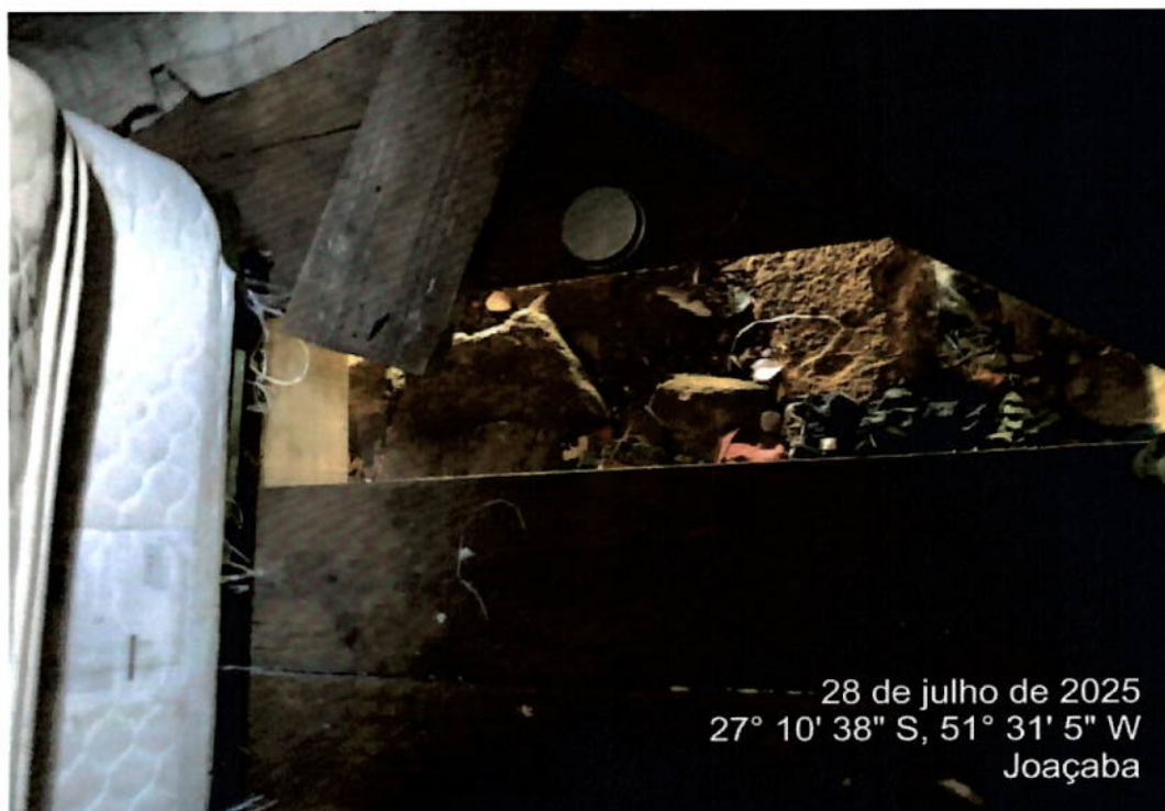
Foto 16 – Vista do assoalho rompido
