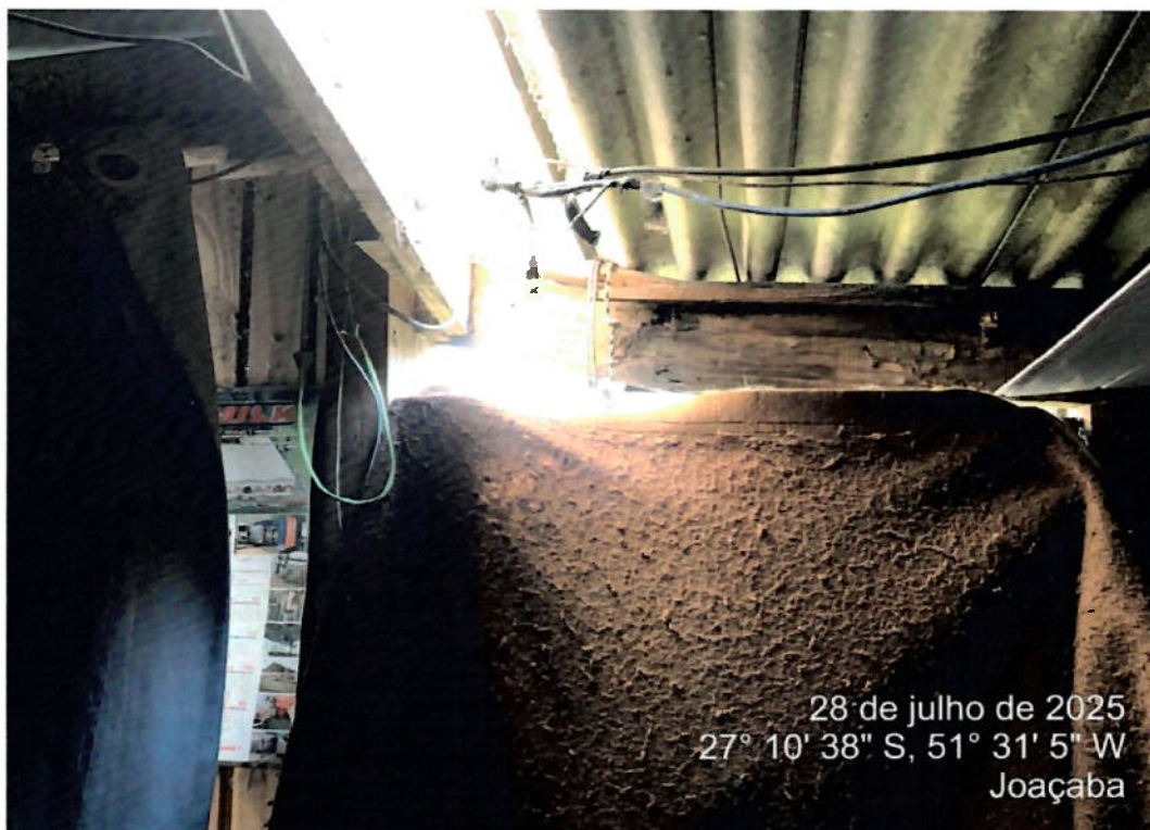
Foto 3 – Vista do rompimento de caibro
