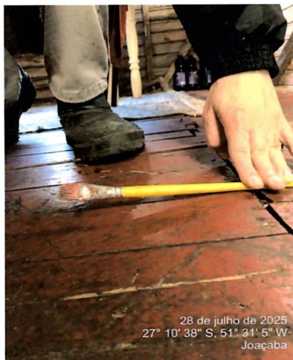
Foto 14 – Vista do abaulamento do assoalho
