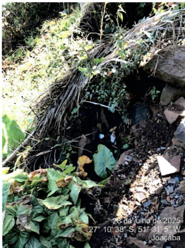
Foto 13 – Vista do deslizamento no talude
