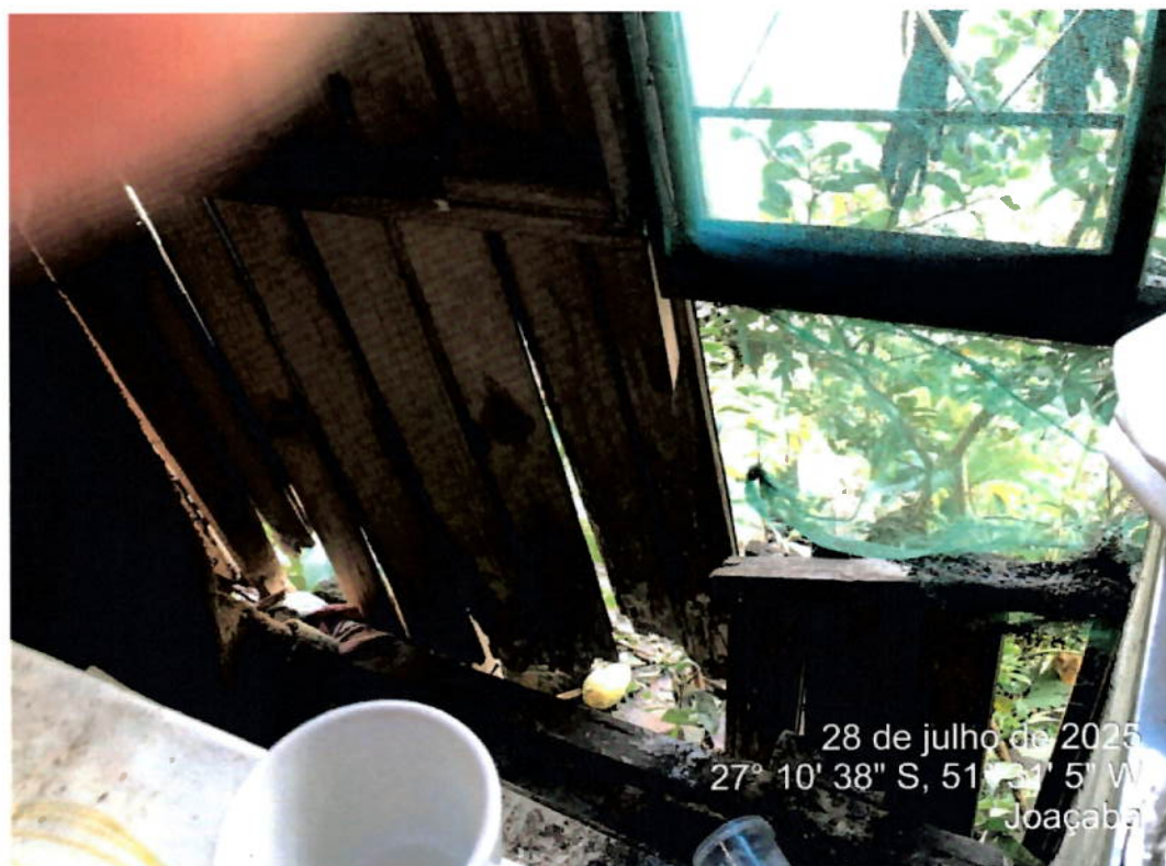
Foto 6 – Vista da parede apodrecida com descolamento
