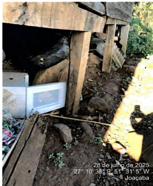
Foto 12 – Vista dos pilares apodrecidos e inclinados
